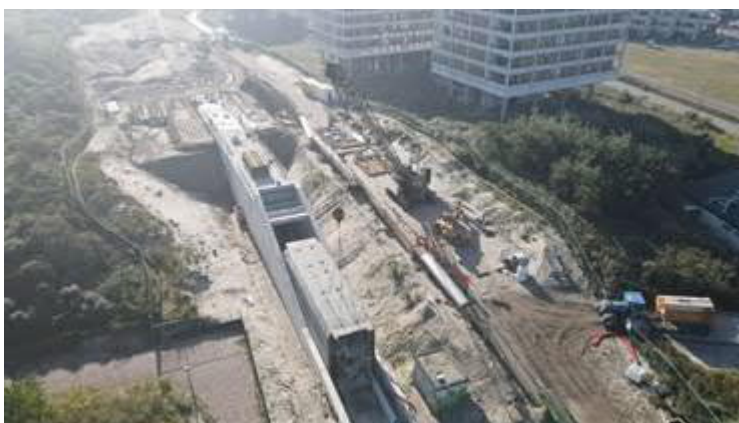
Einde tunnel Strandweg / bij Paviljoensweg (Drone opname) Zandtransport door middel van transportbanden en het ophijzen van de gebruikte tunnelbekisting
