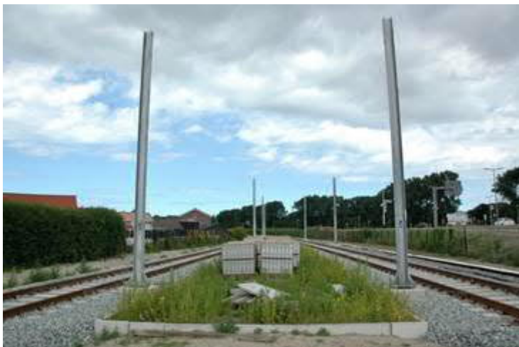
Bovenleidingsportalen in spoorbaan nabij station Hoek van Holland Haven
